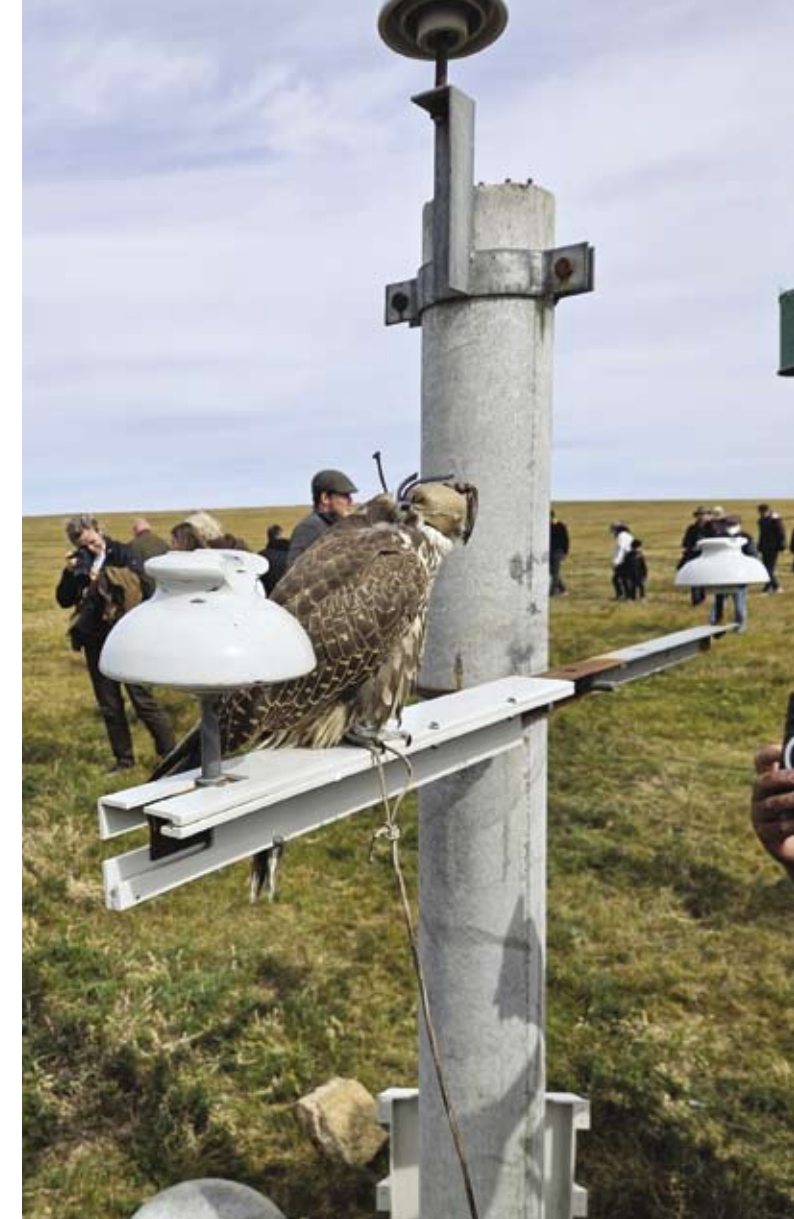
Model słupa w terenowej stacji badawczej ukazujący, na czym polega modyfikacja linii energetycznych. Widać nałożoną plastikową nakładkę, chroniącą siadające ptaki przed porażeniem prądem. Na ziemi widać pokrywę na górną część słupa, a druga część metalowej poprzeczni pokazana jest bez zabezpieczenia. Po prawej stronie widać model gniazda z beczki
